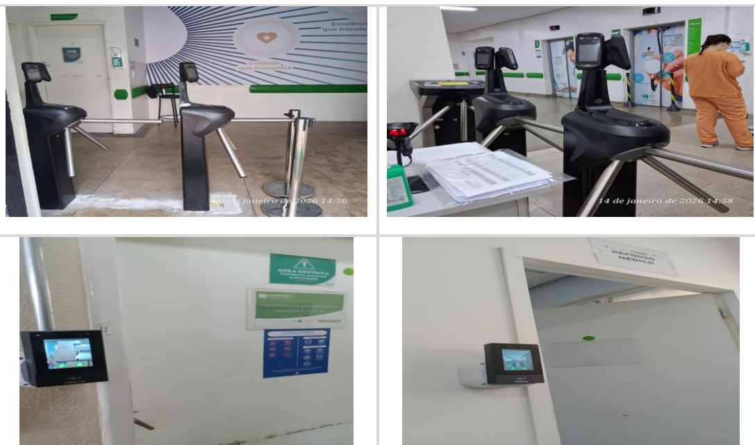
Instalação de Controle de Acesso
